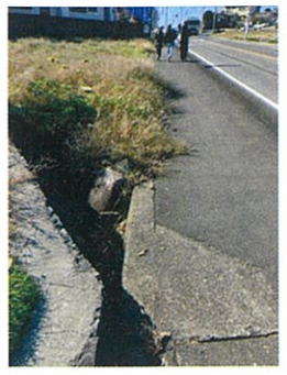
国道251。中学校へ登る途中。大雨の時は道と溝の境がわからず落ちる危険。
